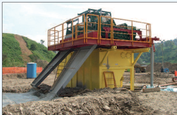
5. Il vibrovaglio di separazione cutting dallo slurry
