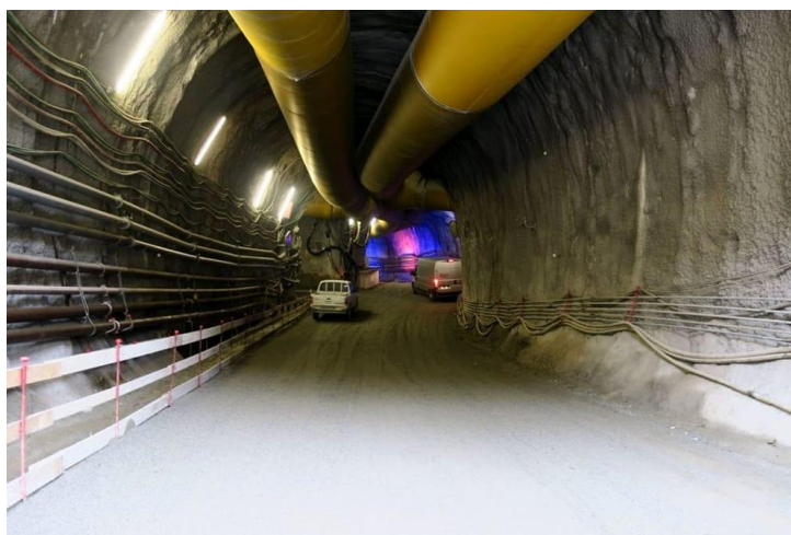
Figura 4 – Tunnel del Brennero. Condotti di ventilazione
