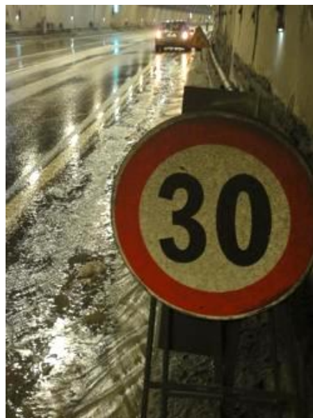
Figura 1 – Venute d'acqua sulla sede stradale
