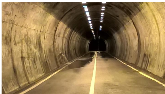
Figura 2 - Importanti venute d'acqua in galleria
