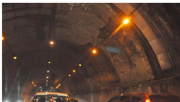
Figura 3 - Degrado del rivestimento causato dalle infiltrazioni
